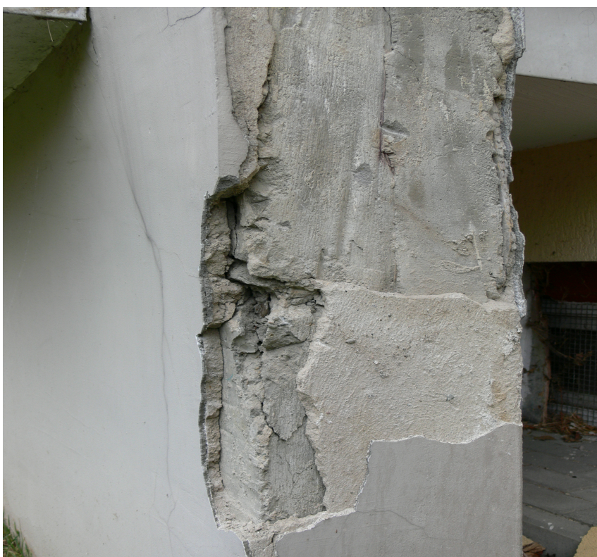
Fot 4. Ściana żelbetowa – widoczna grubość tynku i odspojenie od podłoża
