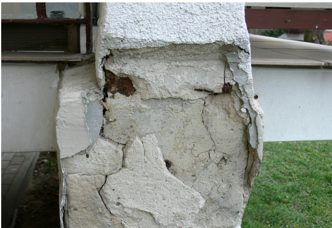
Fot 7. Oparcie słupa ramy na ścianie żelbetowej, widoczna korozja stalowych marek oraz zniszczenia betonu
