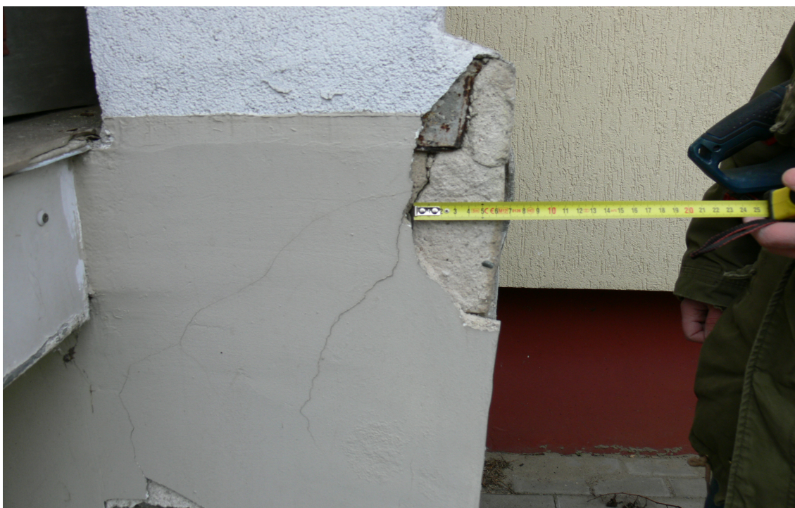
Fot 8. Oparcie słupa na ścianie żelbetowej. Widoczna grubość tynku stanowiącego wypełnienie brakującego betonu ściany.
