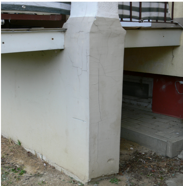
Fot 9. Rysy i pęknięcia na ścianach podpierających słup ramy
