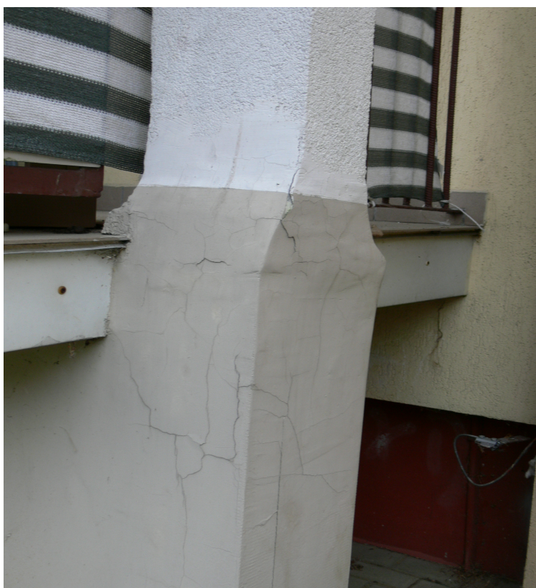
Fot 10. Zniszczenia oparcia słupa na ścianie podpierającej słup
