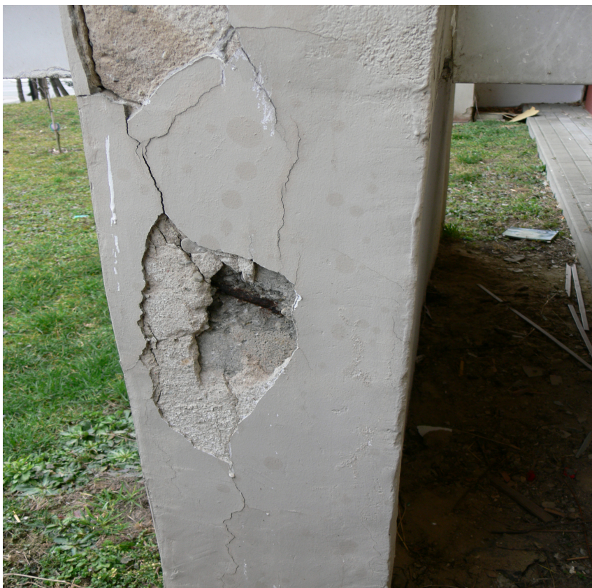
Fot 5. Skorodowane zbrojenie
