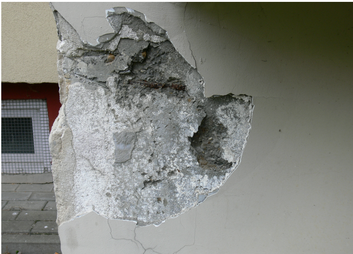
Fot 6. Zniszczenia betonu, skorodowane zbrojenie.
