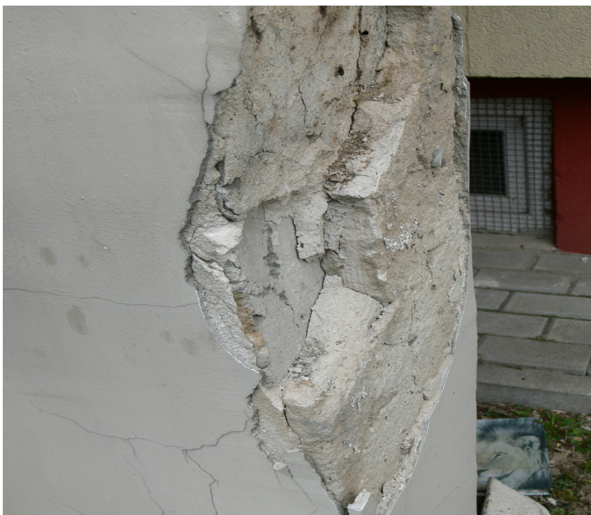
Fot 3. Ściana żelbetowa – widoczna grubość tynku i odspojenie od podłoża
